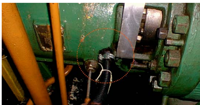
Рис. 5-7. Установка стационарных датчиков ударных импульсов SPM (примеры).
